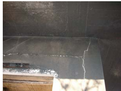
Φωτ. 18: Ρωγμή σε κόμβο δοκού και υποστυλώματος (λόγω θερμικού λακτίσματος)
