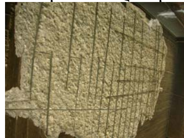
Φωτ. 16: Αποκάλυψη του οπλισμού πλάκας και απώλεια συνάφειας.
