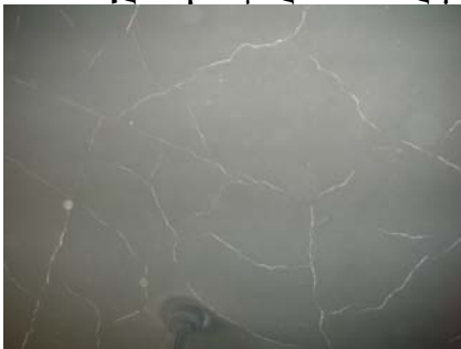
Φωτ. 15: Ρωγμές σε πλάκες
