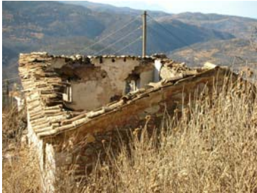
Φωτ. 3: Καύση και κατάρρευση στεγών
