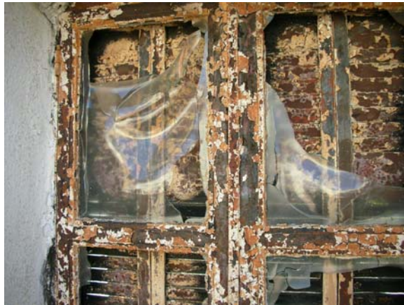
ΕΙΚΟΝΑ 2: ΠΑΡΑΜΟΡΦΩΣΗ ΥΑΛΟΣΤΑΣΙΩΝ ΣΕ ΠΑΡΑΘΥΡΑ ΜΕ ΜΕΤΑΛΛΙΚΟ ΣΚΕΛΕΤΟ
