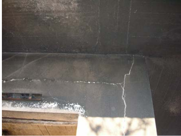
ΕΙΚΟΝΑ 16: ΡΩΓΜΗ ΣΤΟΝ ΚΟΜΒΟ ΔΟΚΟΥ-ΥΠΟΣΤΥΛΩΜΑΤΟΣ (ΛΑΚΤΙΣΜΑ)
