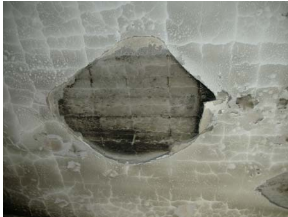
ΕΙΚΟΝΑ 11: ΑΠΟΚΟΛΛΗΣΗ ΚΑΙ ΠΤΩΣΗ ΕΠΙΧΡΙΣΜΑΤΟΣ ΠΛΑΚΑΣ Ω.Σ.
