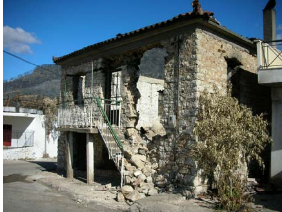
ΕΙΚΟΝΑ 7: ΜΕΡΙΚΗ ΚΑΤΑΡΡΕΥΣΗ ΤΟΙΧΟΠΟΙΑΣ
