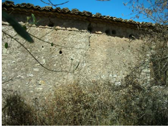
ΕΙΚΟΝΑ 4: ΚΑΤΑΚΟΡΥΦΗ ΡΩΓΜΗ ΣΤΗΝ ΤΟΙΧΟΠΟΙΑ
