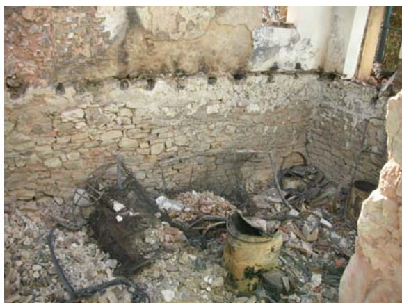
ΕΙΚΟΝΑ 3: ΚΑΥΣΗ ΔΟΚΩΝ ΠΑΤΩΜΑΤΟΣ ΚΑΙ ΚΑΤΑΡΡΕΥΣΗ ΠΑΤΩΜΑΤΟΣ
