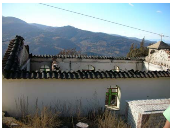
ΕΙΚΟΝΑ 2: ΚΑΥΣΗ ΚΑΙ ΚΑΤΑΡΡΕΥΣΗ ΣΤΕΓΗΣ
