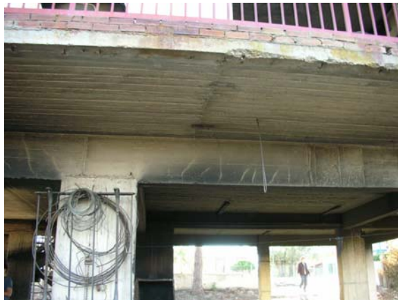
ΕΙΚΟΝΑ 18: ΔΙΑΤΜΗΤΙΚΕΣ ΡΩΓΜΕΣ ΣΕ ΔΟΚΟ
